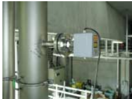
1: Inline-Partikelgrößenmessung beim pneumatischen Transport in einem Rohr DN 200
